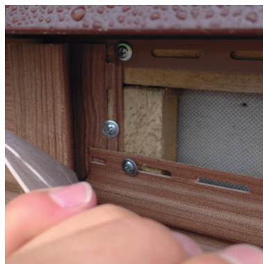
Саморезы вкручены в тело доборного элемента и края перфорации. Отсутствует зазор между шляпкой самореза и доборным элементом. Перекрыт вентиляционный канал.
