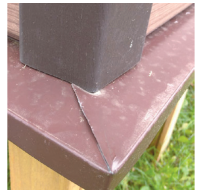
Нет зазора между доборным элементом и отливом.
