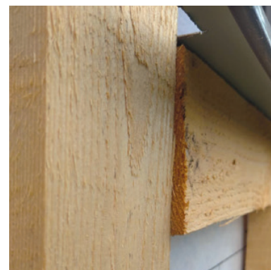
Обрешетка не в плоскости. Перекрыт вентиляционный канал.
