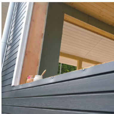
Нет окон, металлического отлива, саморезы вкручены в тело панели сайдинга. Подрезанная панель с предварительно сделанными насечками должна фиксироваться в финишной планке.
