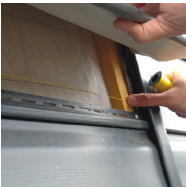
Утеплитель выпирает наружу. Перекрывает вентканал, выталкивает сайдинг.
