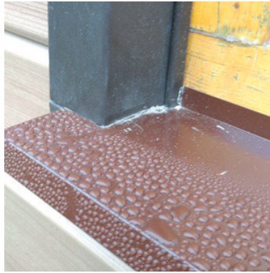
Нет зазора между доборным элементом и металлическим отливом.
