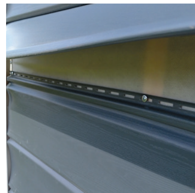
Неправильно смонтирована мембрана. Должна быть установлена до обрешетки. Нет зазора между мембраной и фасадным материалом.
